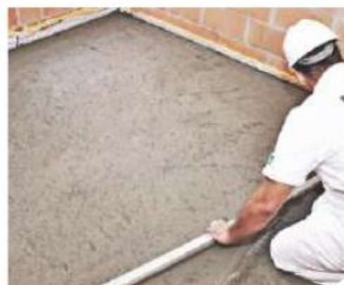
6. Despejar mais 2 cm de massa. Nivelar o contrapiso e aguardar a cura total antes da instalação do revestimento.
