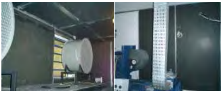
Casas de máquinas - Isosound Véu de Vidro.
